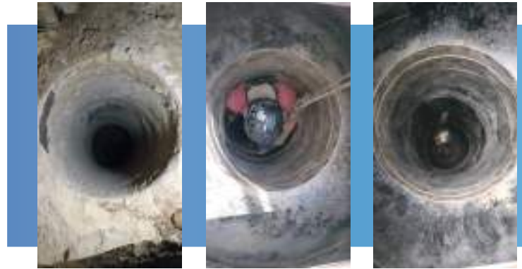
Limpieza de Ciclones
